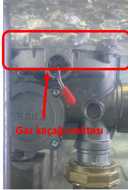
Şekil 2. Membran deformasyonundan kaynaklı gaz kaçağı
